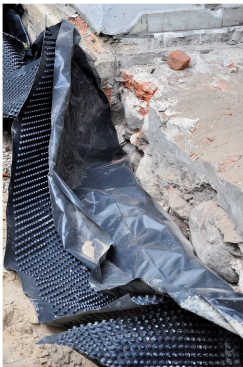
Fot. 1. Przykład zastosowania nieodpowiednich materiałów do izolacji ściany fundamentowej
