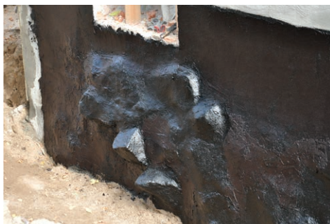
Fot. 3. Widok ściany fundamentowej o silnie profilowanej powierzchni – wmurowane kamienie granitowe o znacznych rozmiarach
